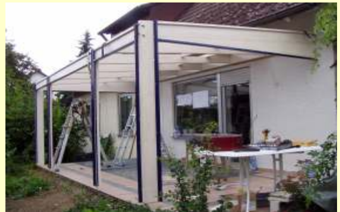
5. Auf die Rahmen des Traggerüsts werden Anschlagprofile aus Aluminium aufgebracht und abgedichtet.
