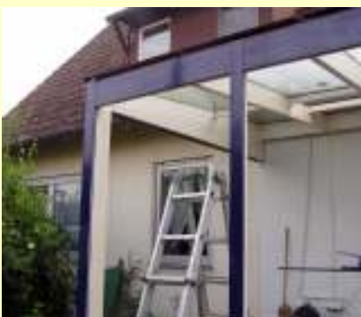
6. Als Verkleidung werden vorgefertigte Kantbleche in die Nuten der Profile geschoben und fixiert.
